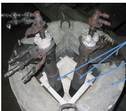
1. плазматроны; 2. огнеупорные блоки; 3. бетонная ловушка
