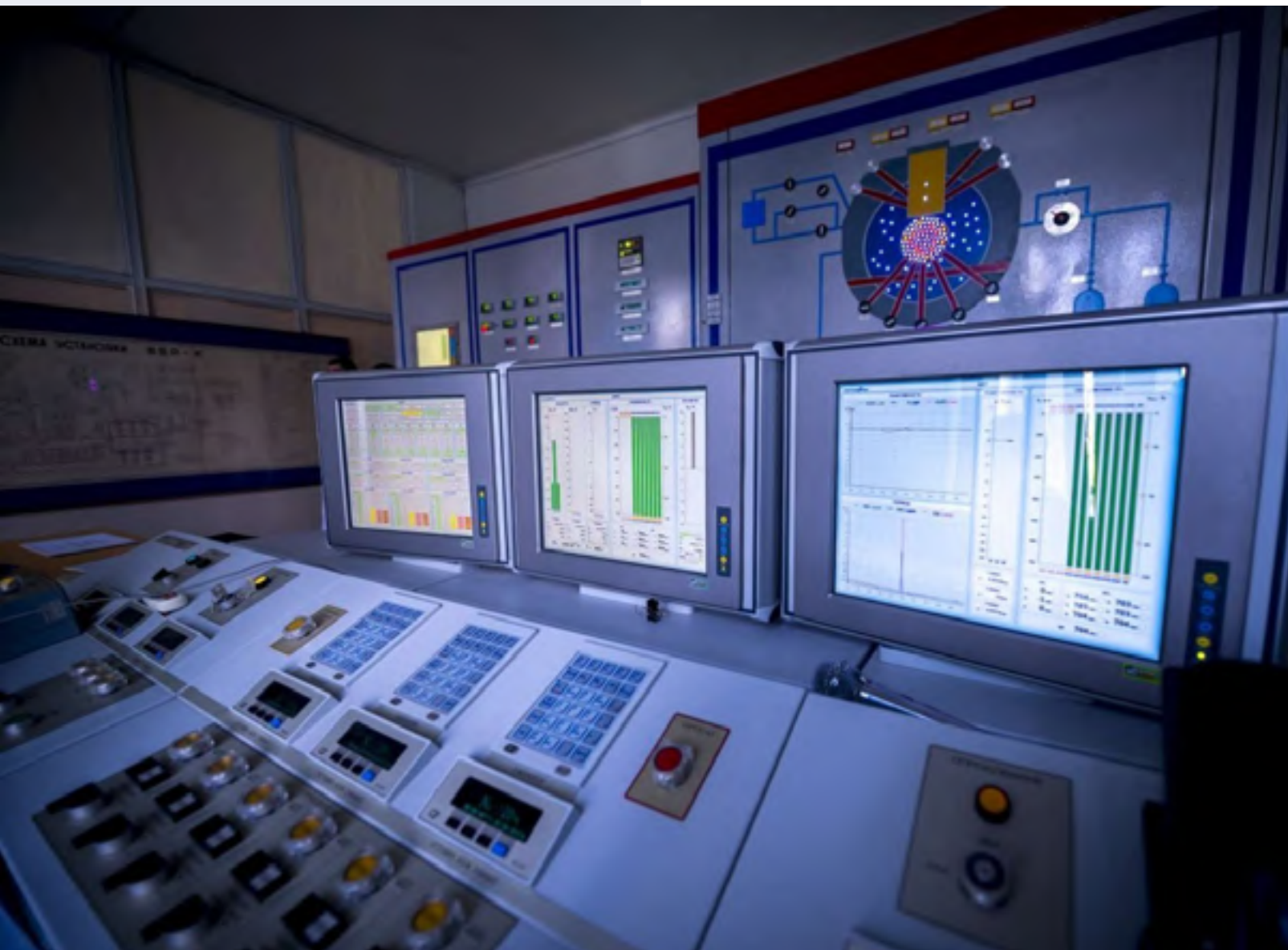
Рис. 10. Модернизированный пульт управления реактором Fig. 10. Modernized control panel of the reactor
