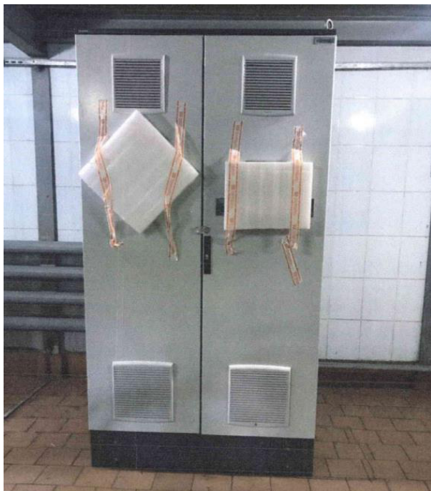
Рисунок 6. Новый шкаф управления печи
